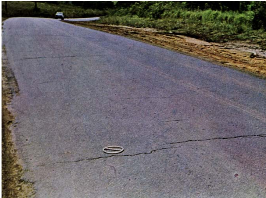
Foto 01: trinca isolada – transversal
