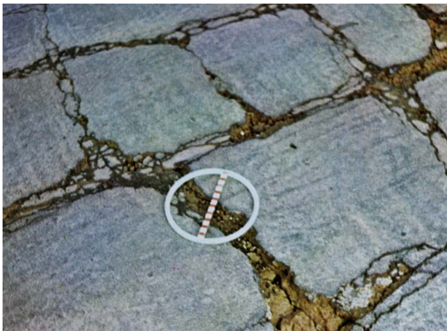
Foto 04: trinca interligada – tipo bloco
