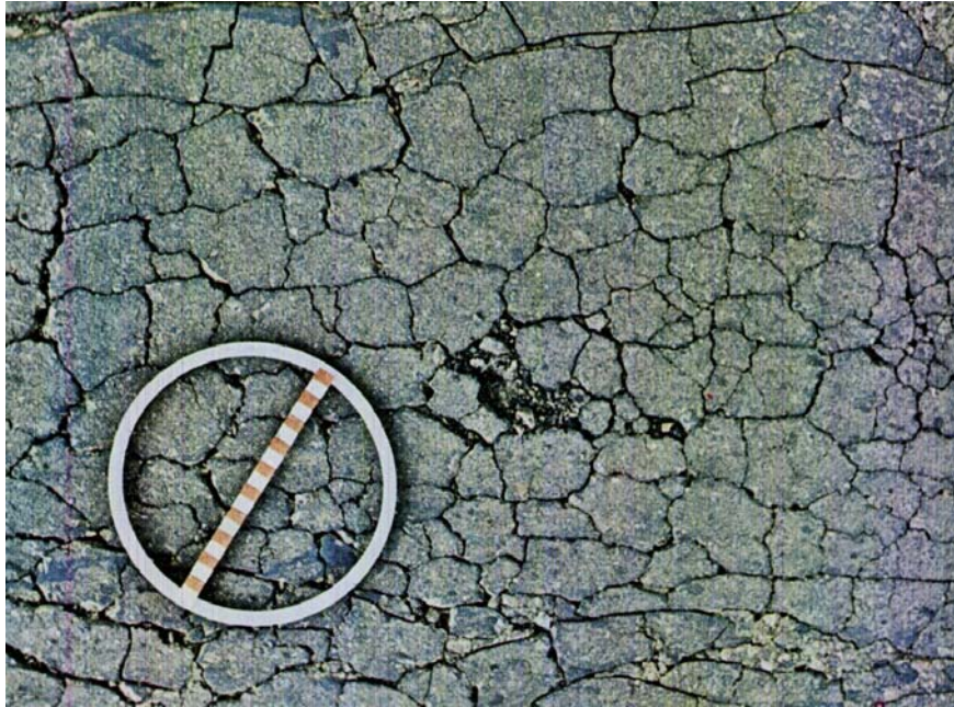
Foto 03: trinca interligada – tipo jacaré
