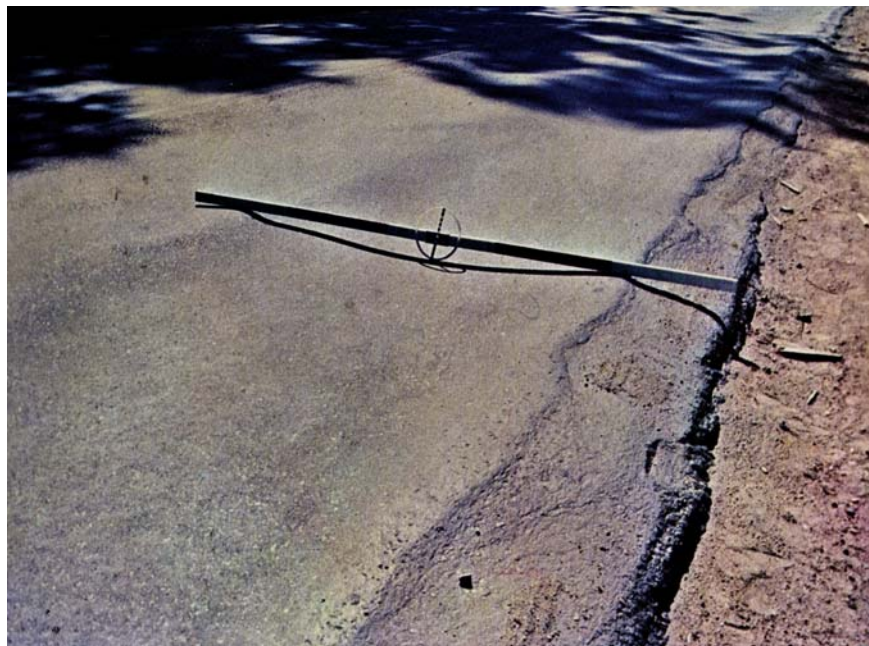
Foto 05: afundamento de trilha de roda
