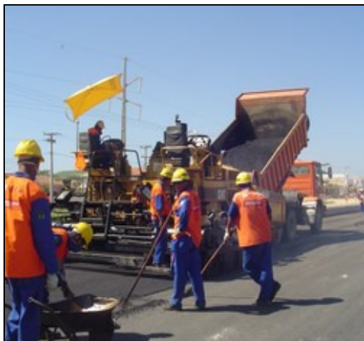
Figura 1. Recebimento do caminhão com a carga de CBUQ e espalhamento com a vibroacabadora.
