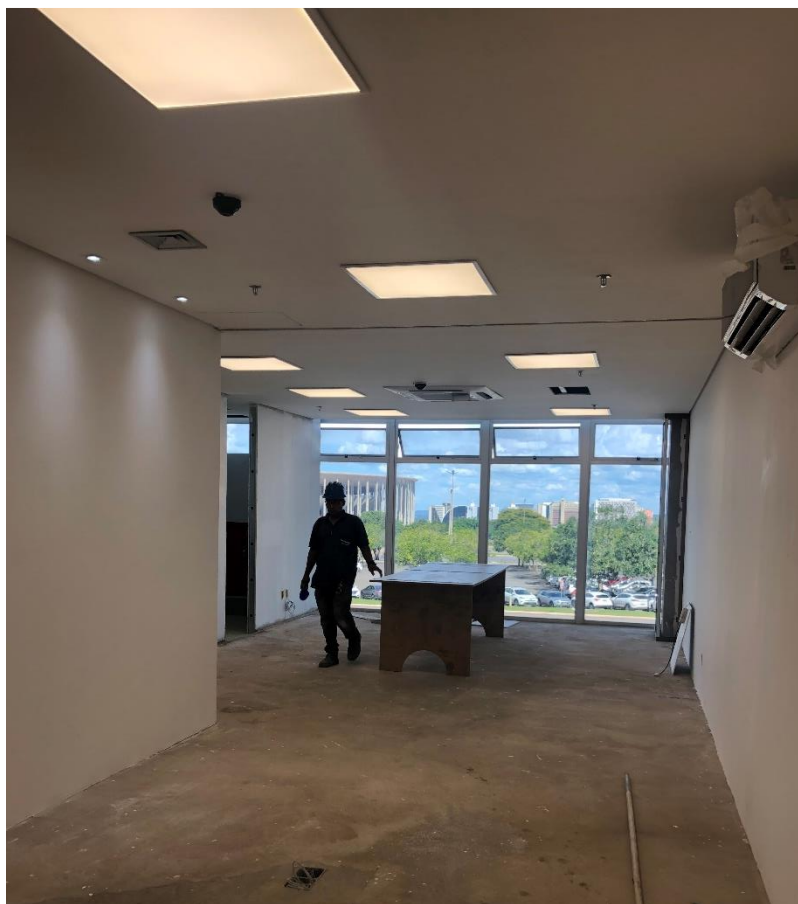
Figura 32 - Gabinete com divisórias em DryWall Fonte: Arquivo da autora
